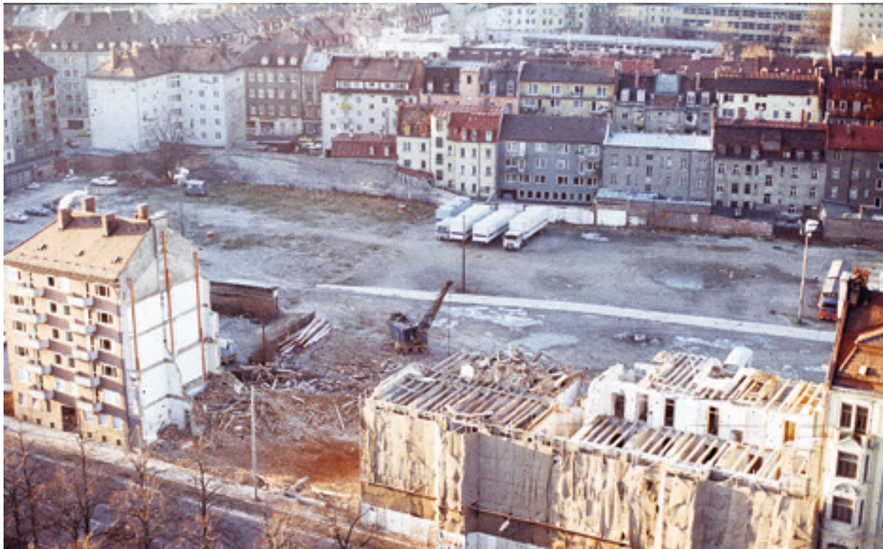
Bild rechts Abriss der Häuser an der Erhardtstraße für den Neubau des Europäischen Patentamts. Der Zuschlag zu den Abrissarbeiten über 400.000 DM wurde an vier Firmen vergeben. SZ, Sammlung Karl Klühspies
